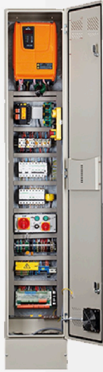
كنترول مصعد بدون غرفة VVVF
